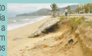
Erosão na praia de Massaguaçu, Caraguatatuba, SP
